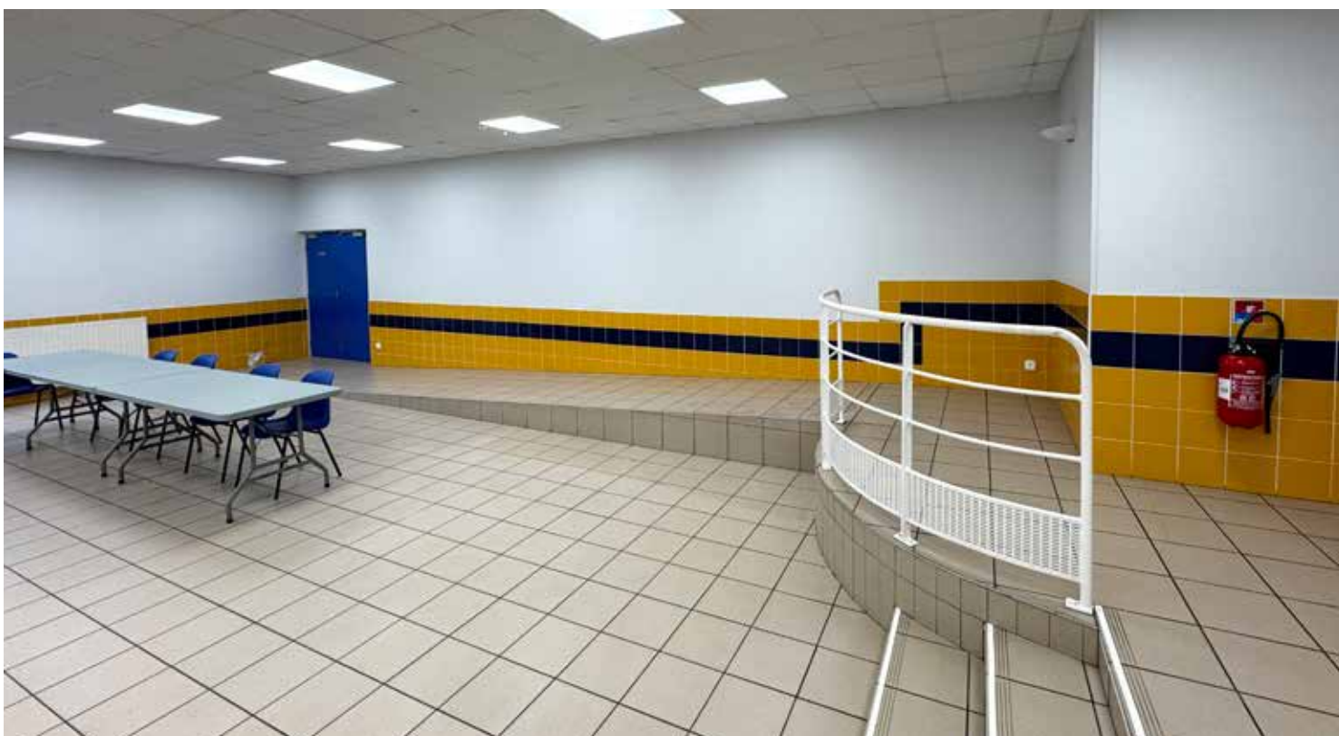
> Rampe d'accès pour personnes handicapées ou à mobilité réduite
