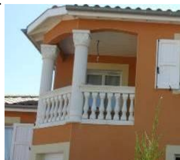
Type de balustres interdits
